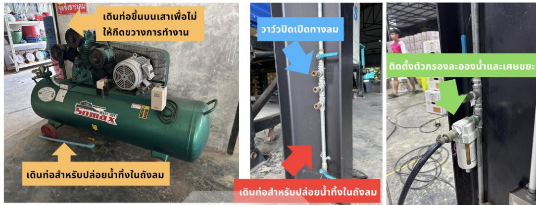
ภาพที่ 5.1: ท่อปั๊มลมและปั๊มลม
